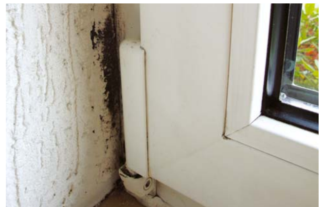
Schimmelbelastung im Nischenbereich eines Fensters
