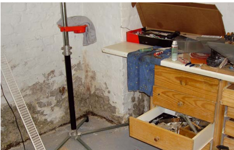
Mangelnde Luftzirkulation hinter Mobiliar
