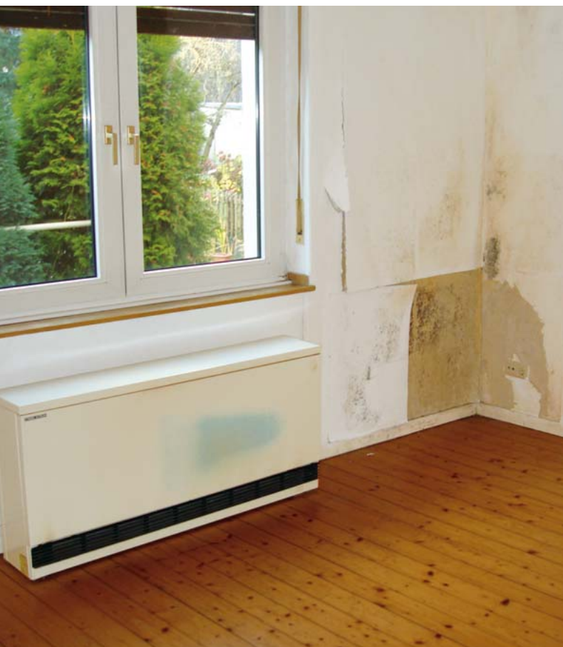
Typischer Schaden bedingt durch Wärmebrücken und mangelnde Luftzirkulation
