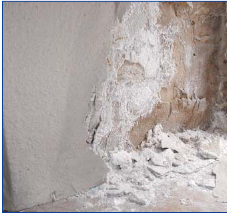
1 Nasses, salzbelastetes und durchfeuchtetes Mauerwerk.
