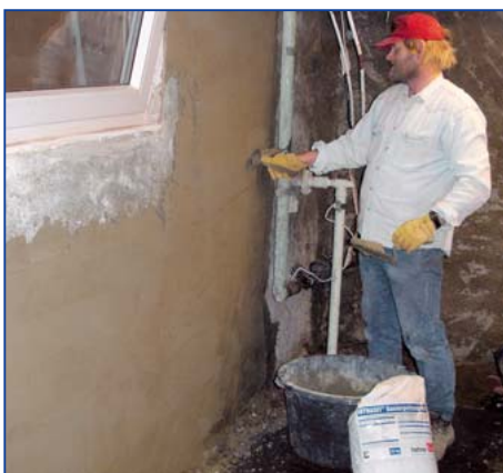
7 Das anschließende Verputzen der Wandflächen mit INTRASIT® Sanierputz WTA grau/weiß oder -SanUno erfolgt nach den Regeln der Putztechnik zweilagig bis 20 mm.
